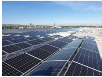
ÖBB Inzersdorf 2.031 kWp
